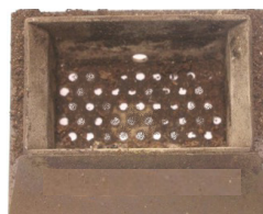
Cestello che necessita di pulizia con i fori otturati dalla cenere
